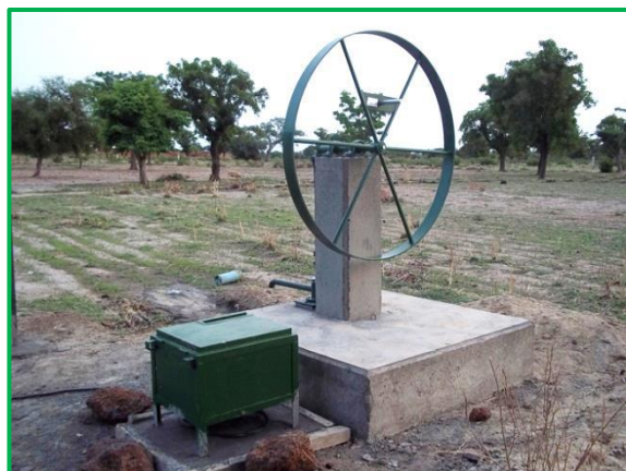
Puits avec pompe à énergie solaire
