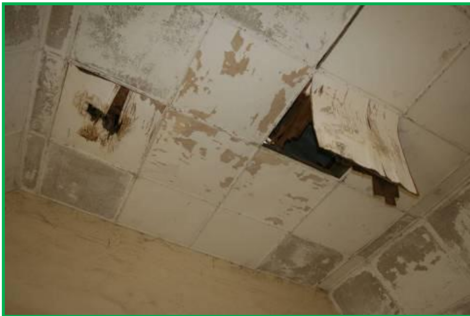
Etat actuel des plafonds des salles de classes à réhabiliter
